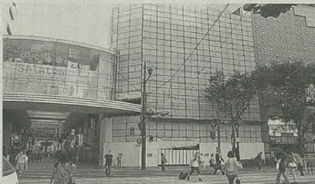
明和不動産の商業ビル建設予定地。現在、旧ビルの解体が進められている。熊本市
